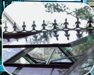
Dachfenster mit automatischen Fensteröffnern
