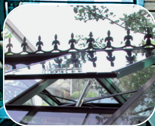
Dachfenster mit automatischen Fensteröffnern
